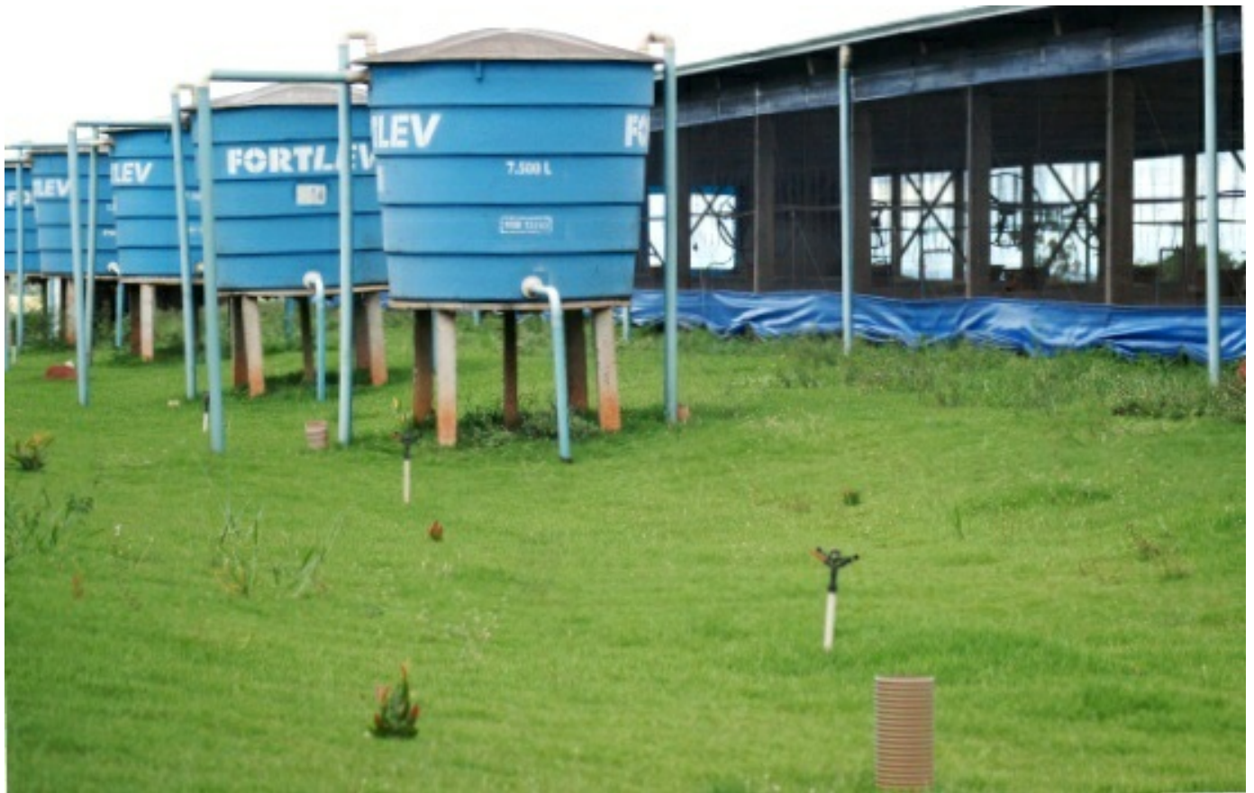
2. Dos telhados dos barracões para as cacimbas e de volta para as caixas, a água segue por canos enterrados
